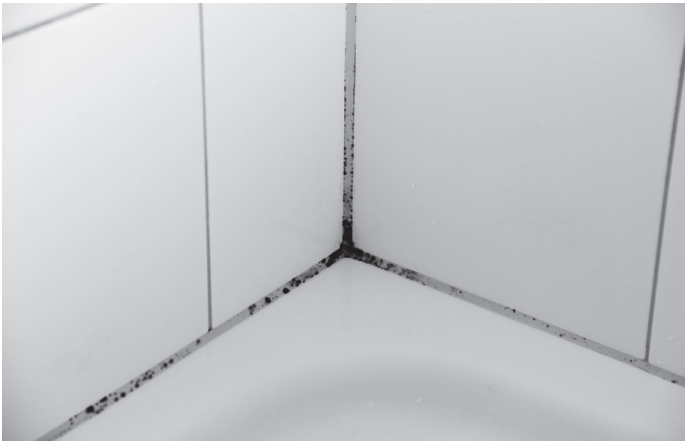
Schimmel an Silikonfuge im Bad
