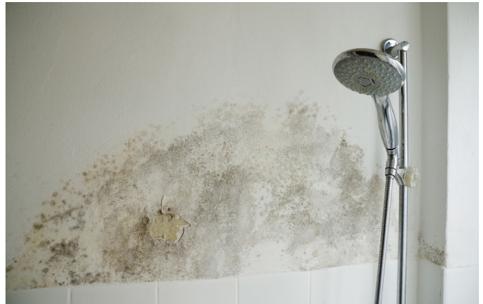
Wasserschaden an der Wand
